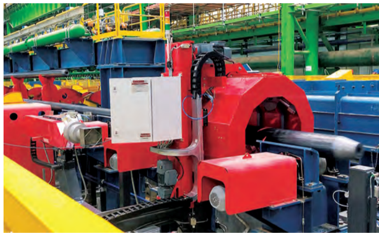
Установка контроля геометрических параметров и поверхностных дефектов оправок
